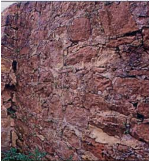
Direkt neben der aktuellen Baustelle haben Feuchtigkeit und Bewuchs für den Verfall eines Mauerpfieilers geführt, der weg zu brechen droht. (Foto: Henkel)
